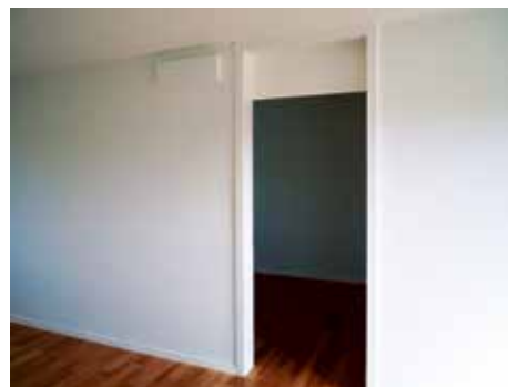
Der Verbundlüfter fördert Luft aus dem Wohnzimmer ins Schlafzimmer.
