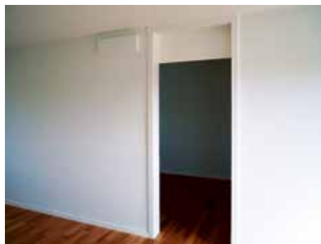
Le ventilateur mixte transporte l'air de la chambre à coucher dans le séjour.
